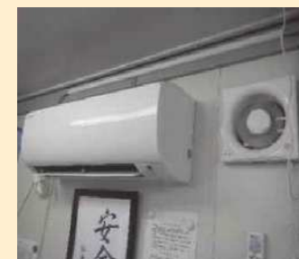
扇風機や換気扇とエアコンを併用
