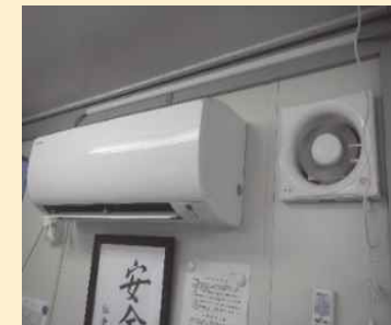
扇風機や換気扇とエアコンを併用
