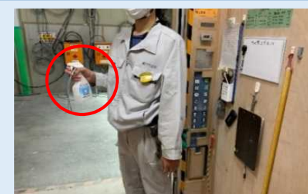
EVの操作盤等の消毒を徹底
